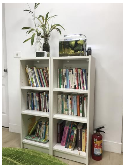
等待區備有滅火器
