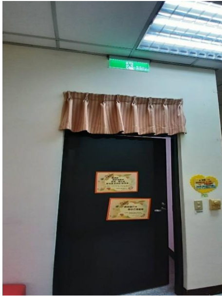
照片內容說明 M 棟諮商室(M005)大門設置緊急出口標示，供避難逃生時使用。
