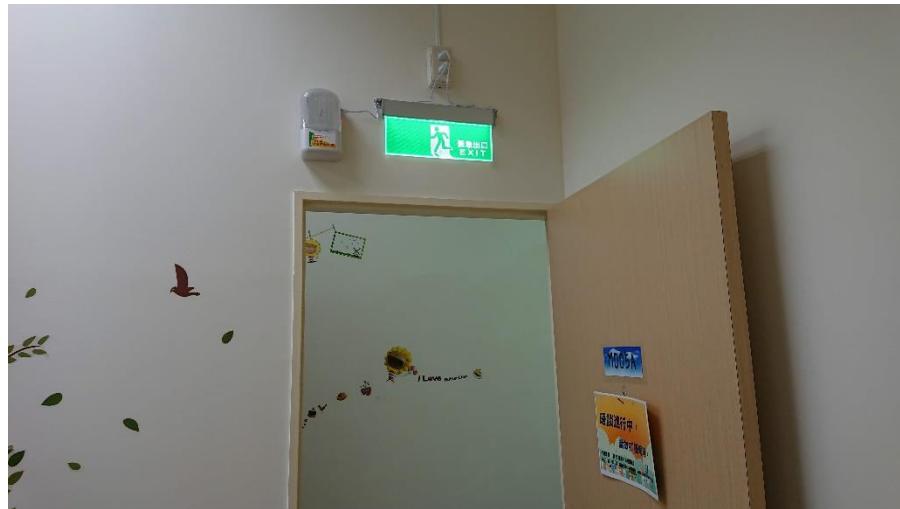
照片內容說明 M005(A)個諮室設置緊急出口及照明設備，供避難逃生時使用。
