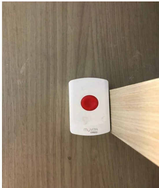
諮商空間皆設置緊急鈴之相關設備
