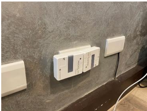
說明：1樓警鈴設置
