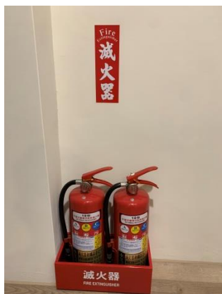
說明：3 樓滅火器
