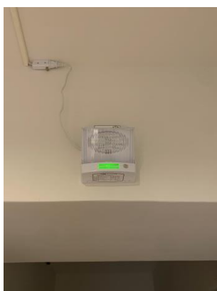
說明：2 樓緊急照明 1
