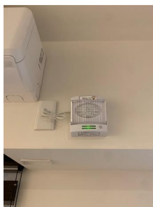
說明：3 樓緊急照明 2
