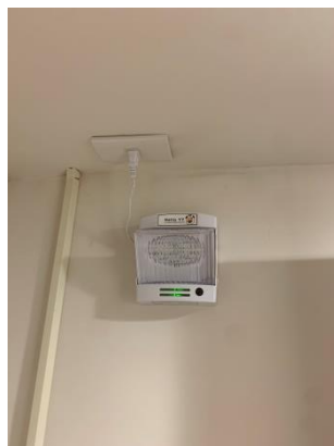
說明：3 樓緊急照明 1
