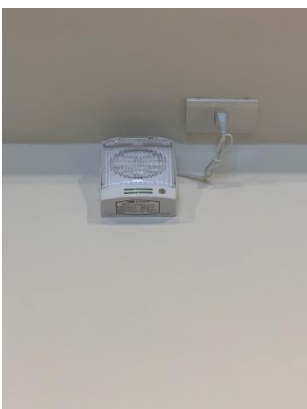
說明：1 樓緊急照明
