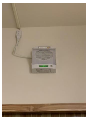
說明：2 樓緊急照明 2
