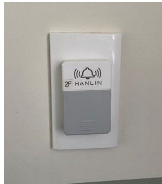
說明：2樓警鈴設置
