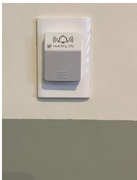
說明：3樓警鈴設置
