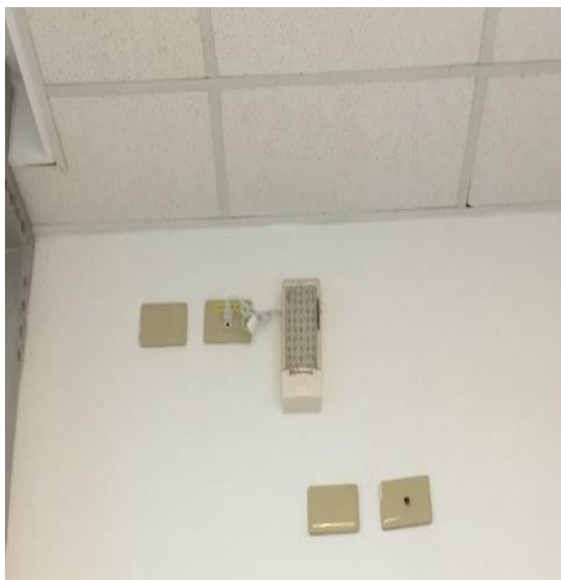
安全設施（緊急照明設備）
