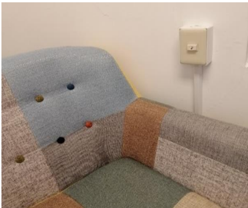
安全設施（警鈴設置）
