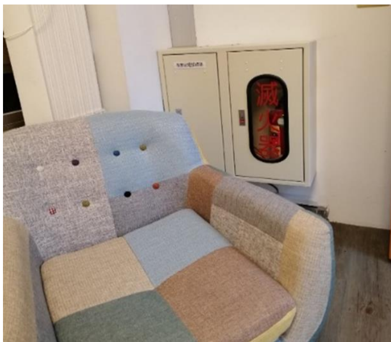
安全設施（消防設備）
